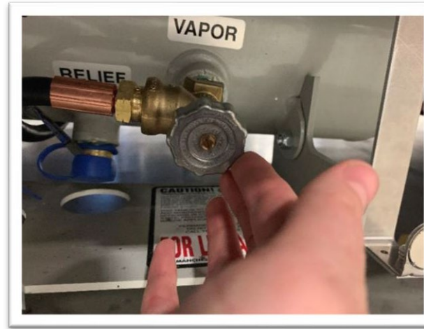
Robinet du réservoir de propane
