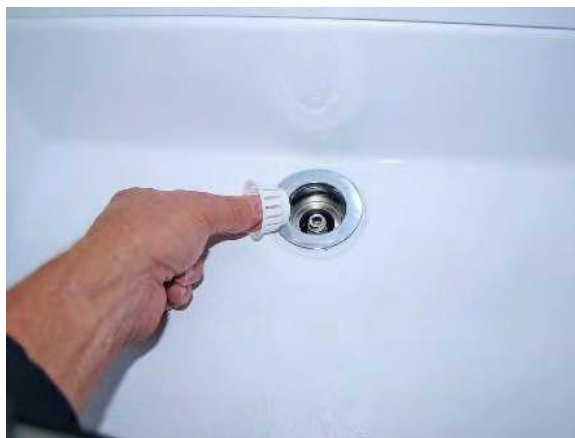
25.2 Avaloir de douche
