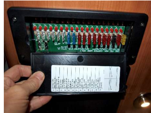
12 volt DC fuse box
