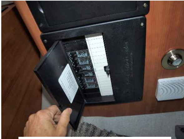
120 volt AC distribution center
