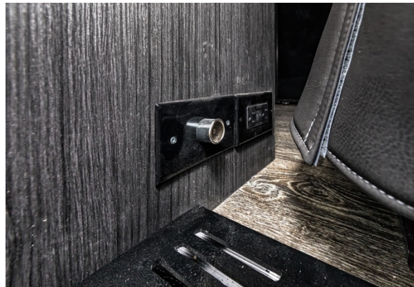
Figure 57.3 Disjoncteur de fuite à la terre et prises 12 V.
