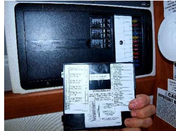
120 volt AC breakers and 12 volt DC fuses
