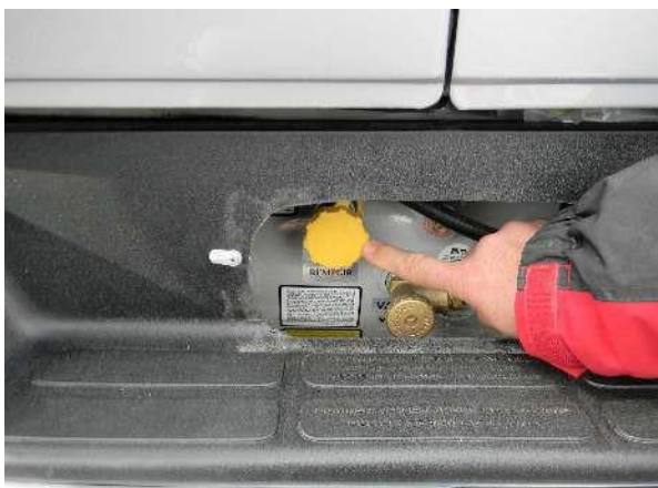
Propane fill valve
