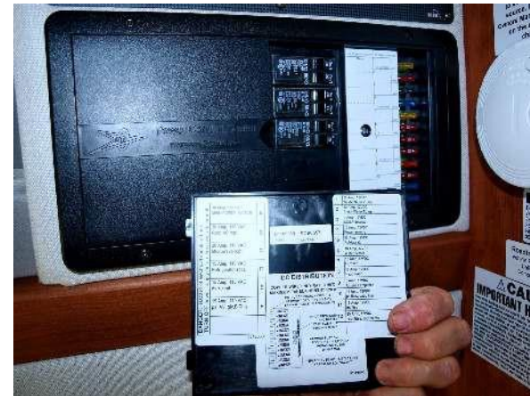
120 volt AC breakers and 12 volt DC fuses
