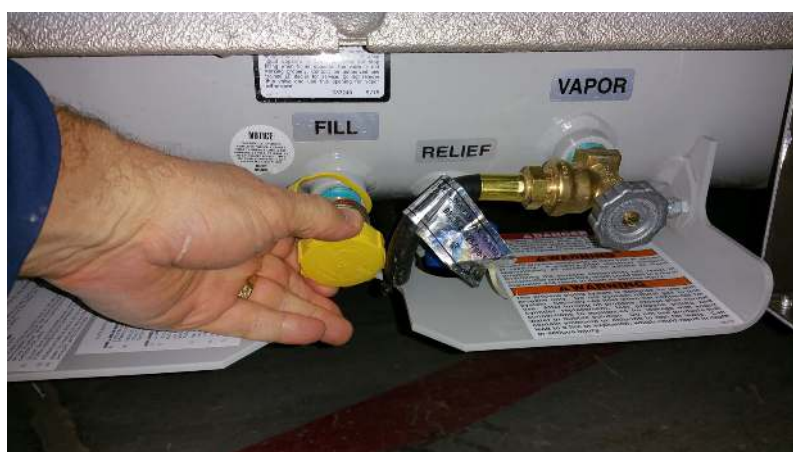
Propane fill valve
