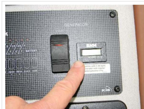
Generator hour meter
