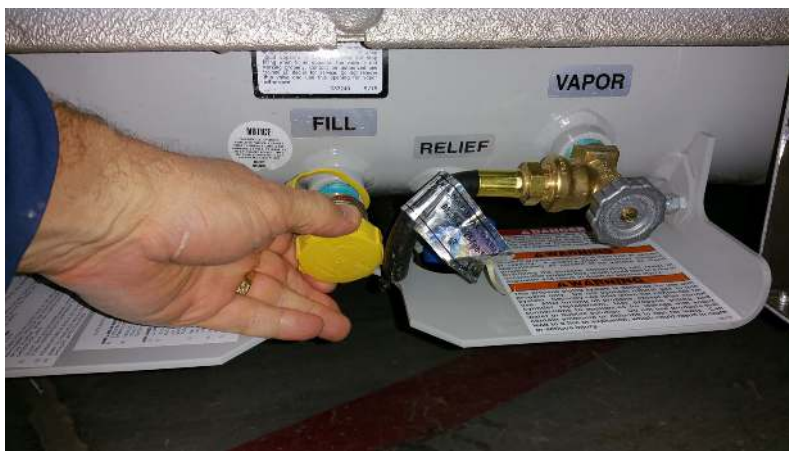
Propane fill valve
