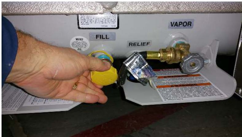
Propane fill valve
