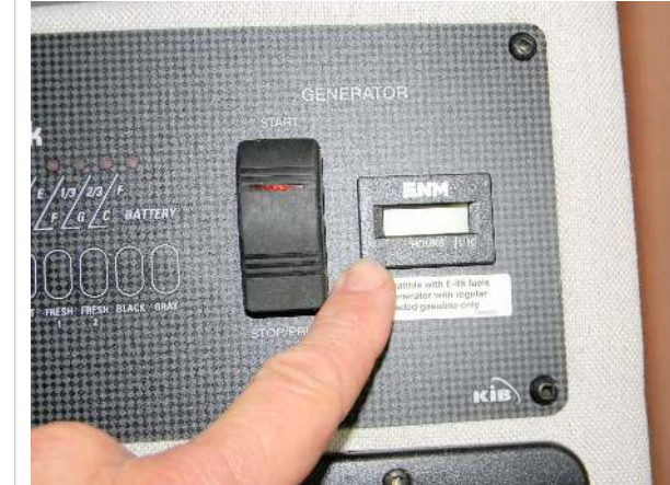
Generator hour meter
