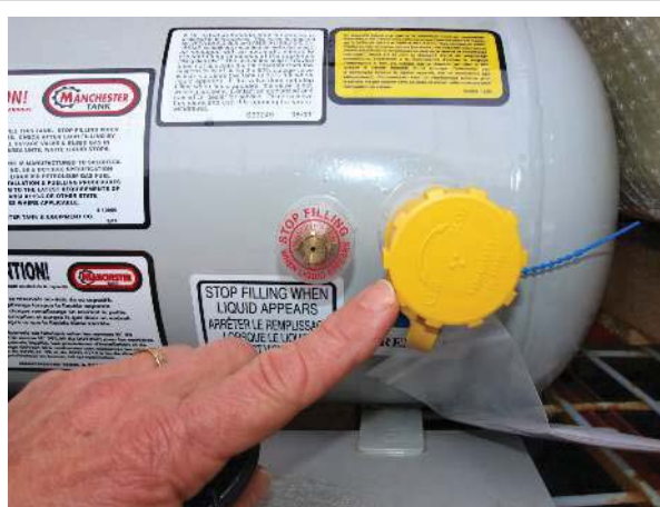
Propane fill valve
