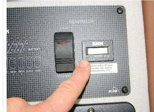
Generator hour meter
