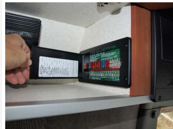
12 volt DC fuse box open
