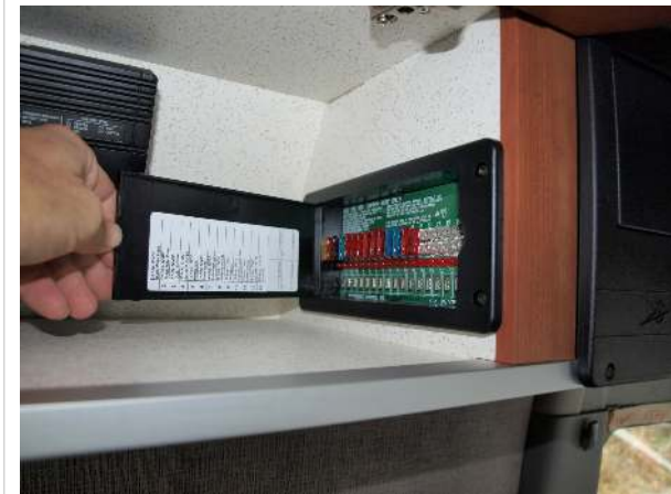
12 volt DC fuse box open
