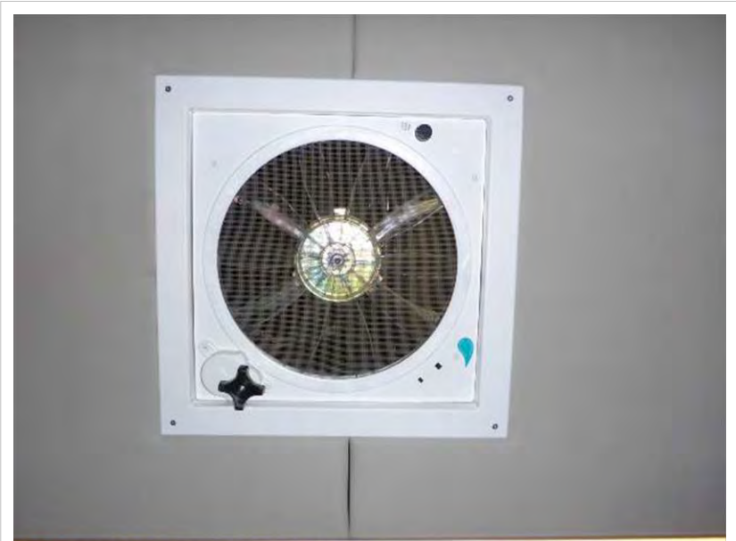
Ceiling ventilation fan
