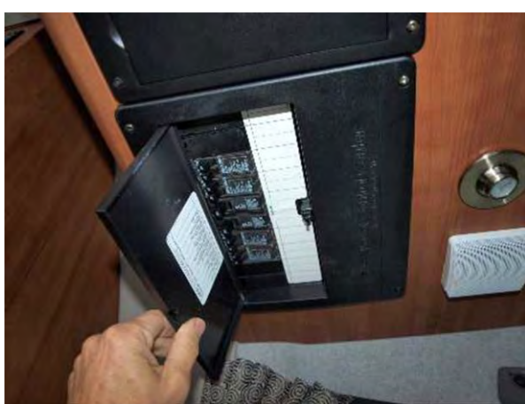
120 volt AC distribution center
