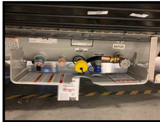
36.5 Réservoir de propane
