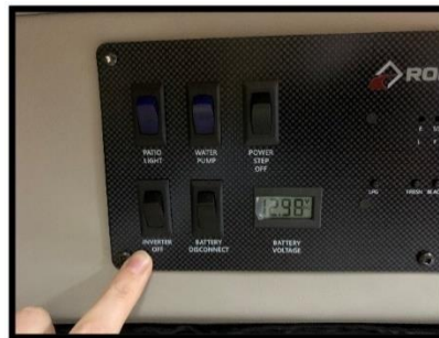
Interrupteur de l'onduleur 43.2
