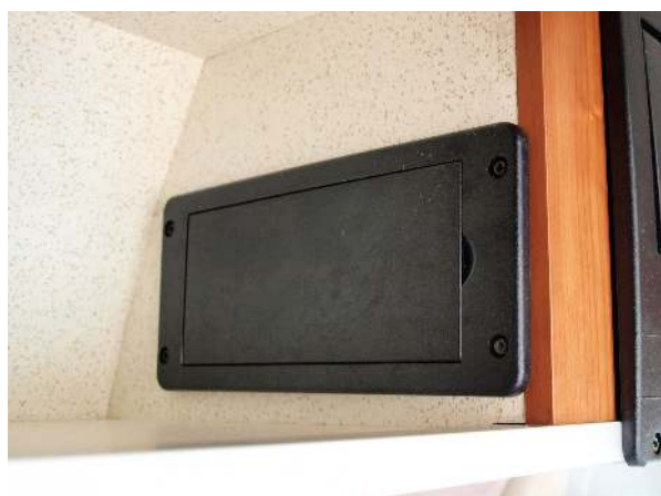
12 volt DC fuse box
