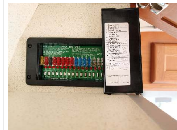
12 volt DC fuse box open
