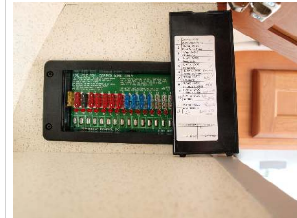
12 volt DC fuse box open
