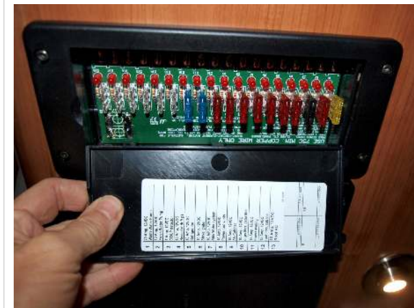
12 volt DC fuse box
