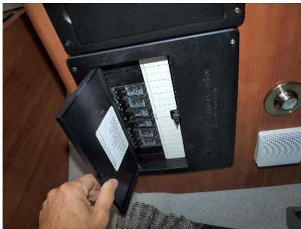
120 volt AC distribution center
