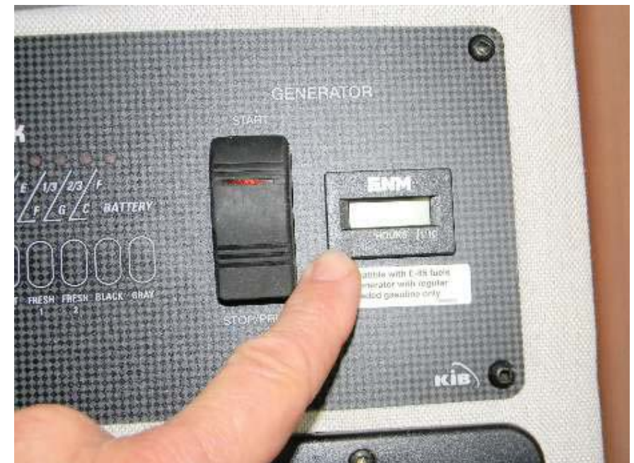
Generator hour meter
