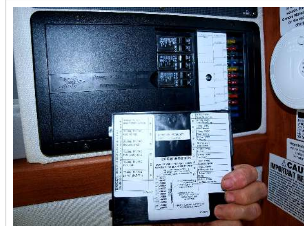
120 volt AC breakers and 12 volt DC fuses
