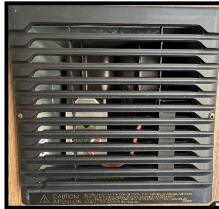
35.2 Furnace vent inside the van
