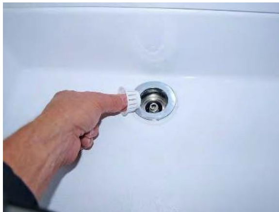
25.2 Avaloir de douche
