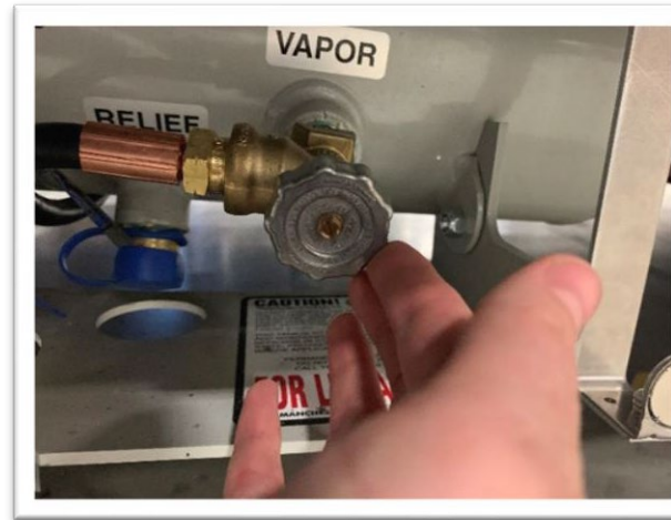
Robinet du réservoir de propane
