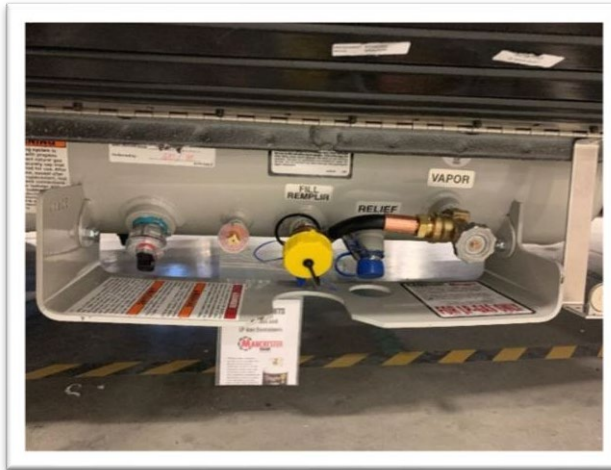
Réservoir de propane
