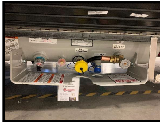
36.5 Réservoir de propane
