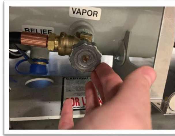
Robinet du réservoir de propane
