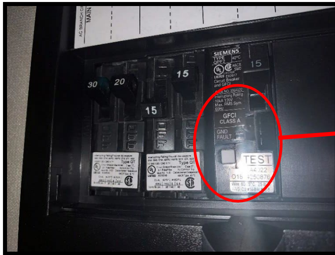
Disjoncteur de fuite à la terre dans le panneau de fusibles au-dessus du siège du conducteur
