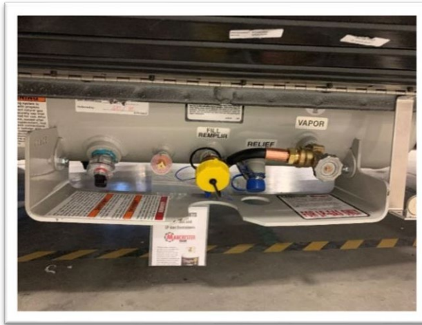
Réservoir de propane
