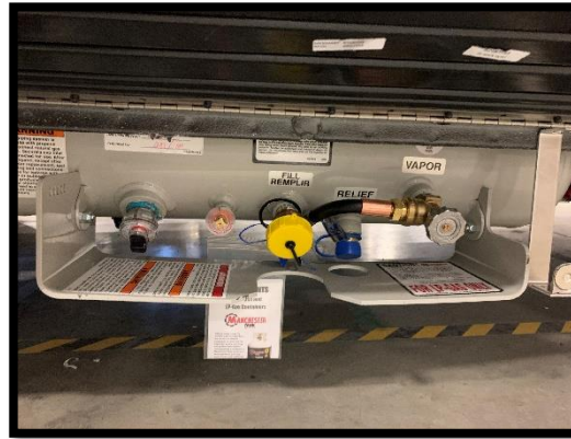
36.5 Réservoir de propane
