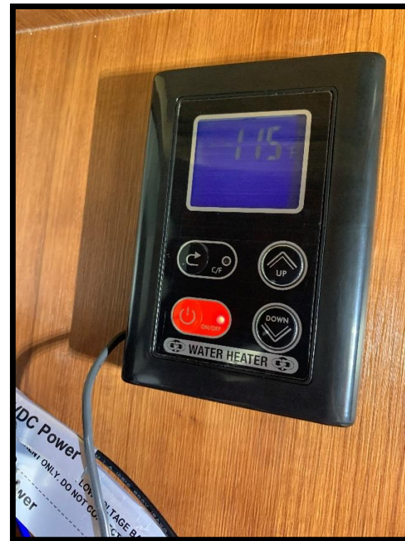
26.3 Panneau de commande du chauffe-eau
