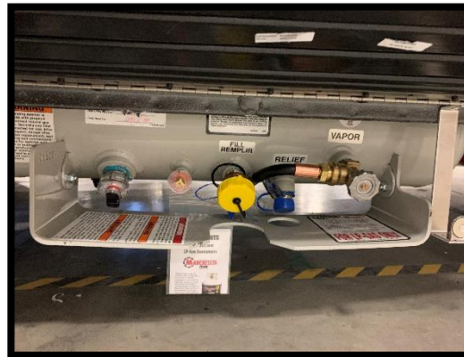
36.5 Réservoir de propane
