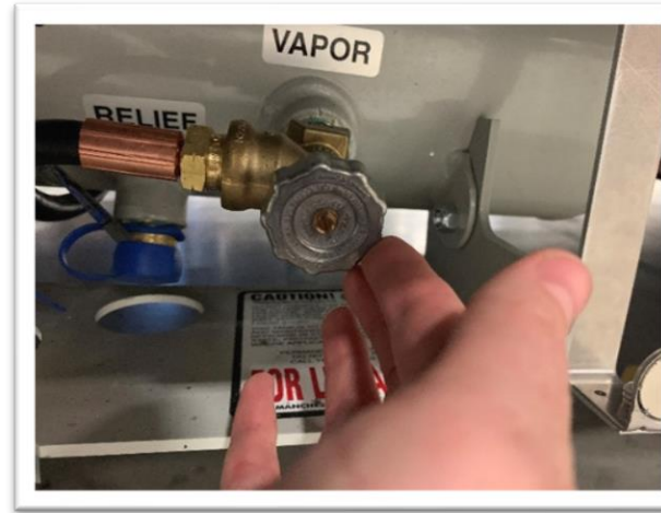
Vanne d'arrêt principale du réservoir de propane
