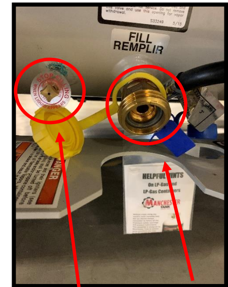
Soupape d'évacuation et vanne de remplissage du propane
