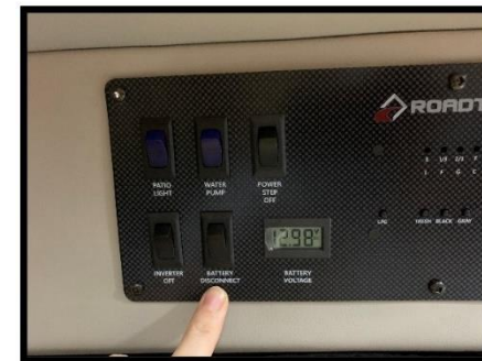
Interrupteur-sectionneur de la batterie
