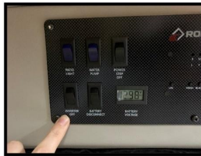
Interrupteur de l'onduleur 43.2
