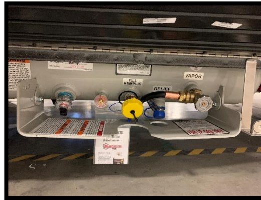
36.5 Réservoir de propane
