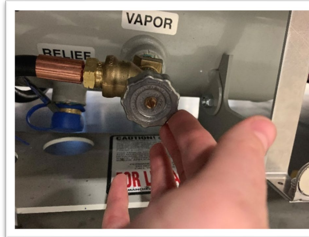
Robinet d'arrêt principal du réservoir de propane
