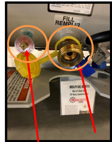
Vanne de purge de propane et vanne de remplissage de propane
