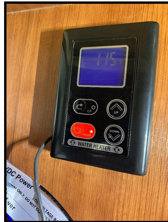
Image 29.3 Panneau de commande du chauffe-eau
