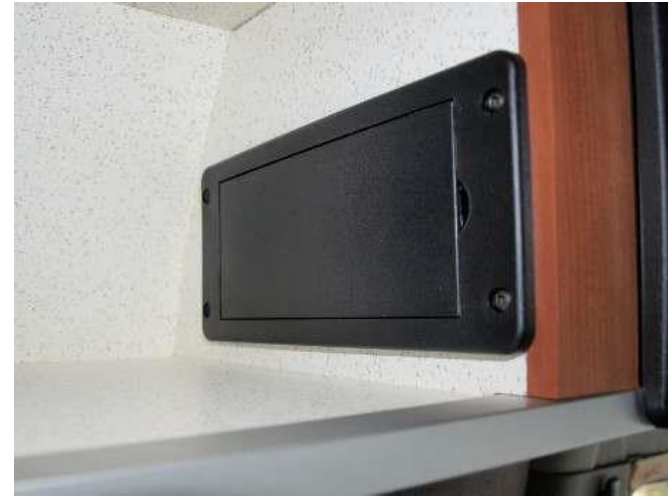
12 volt DC fuse box
