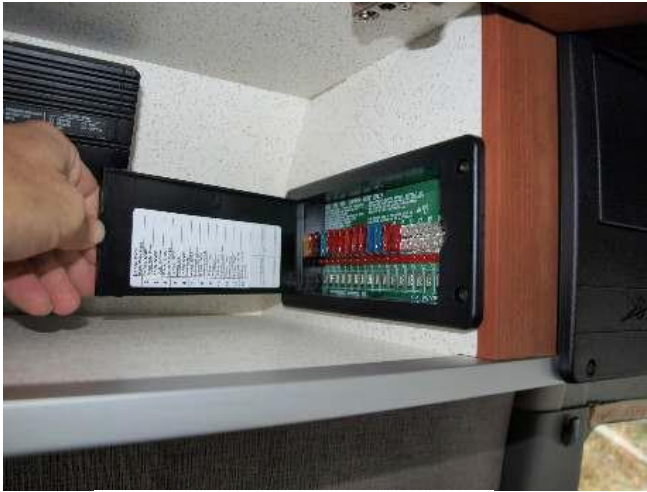
12 volt DC fuse box open
