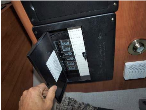
120 volt AC distribution center
