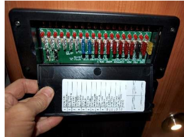
12 volt DC fuse box
