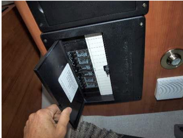
120 volt AC distribution center
