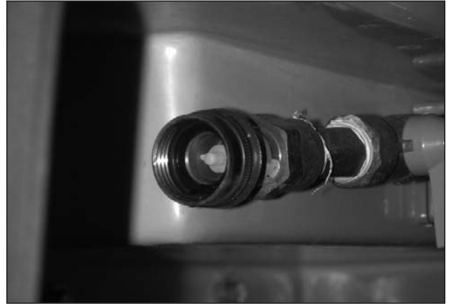
Photo G-P0: Clapet d'arrêt du raccordement externe
