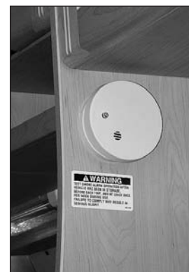
Photo F-P3A: Détecteur de fumée (Versatile)
