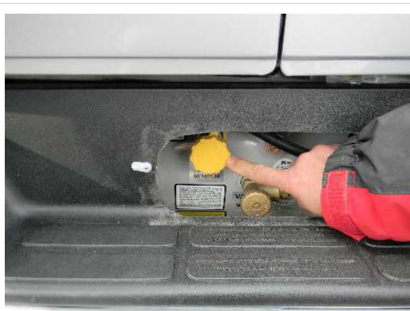
Propane fill valve
