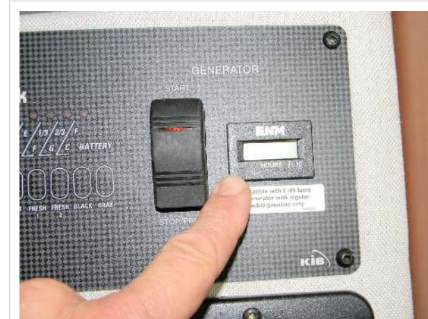
Generator hour meter
