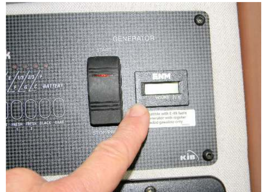
Generator hour meter
